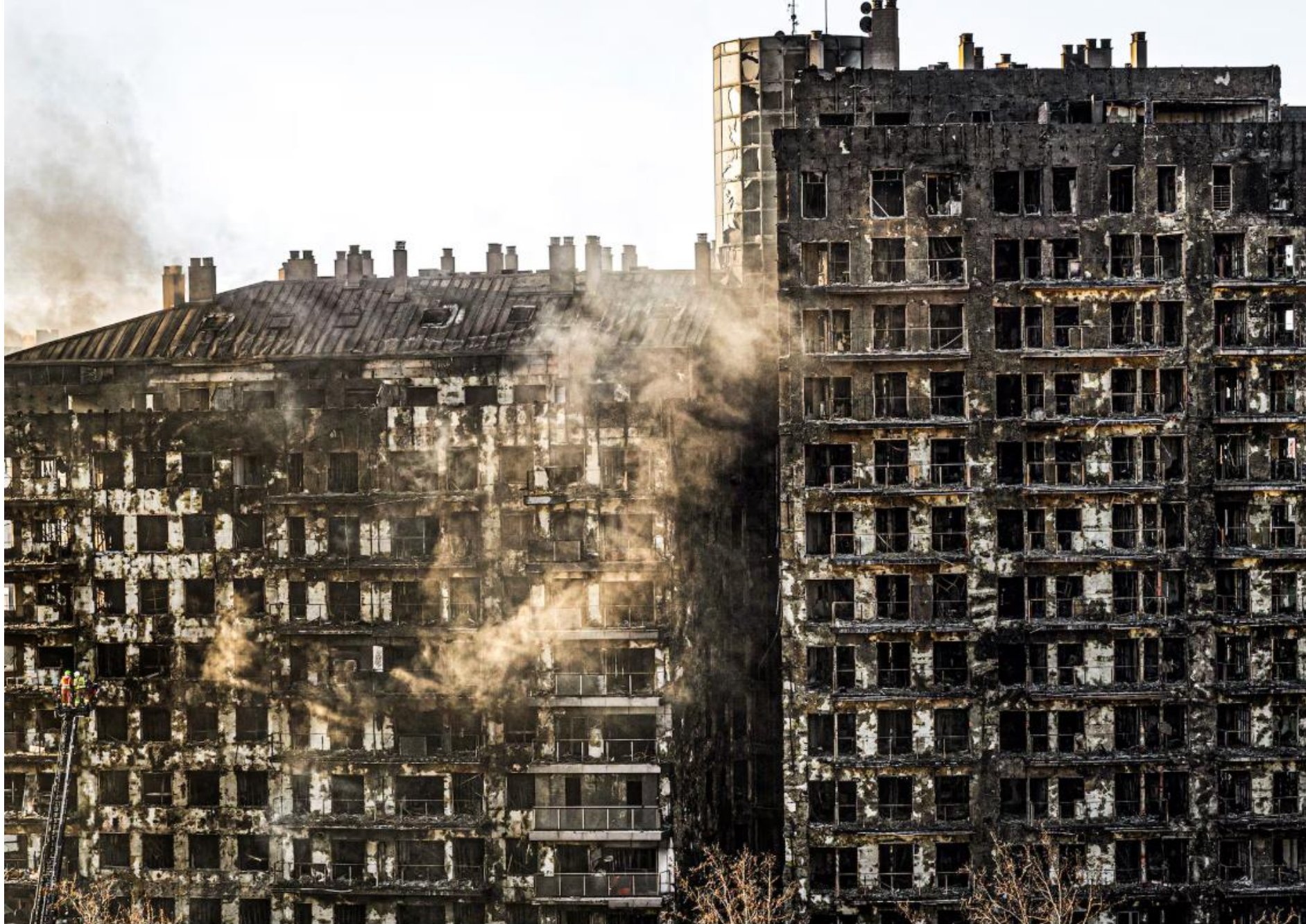
11. Estado del edificio del barrio de Campanar de Valencia donde fallecieron 10 personas, el 23 de febrero.
